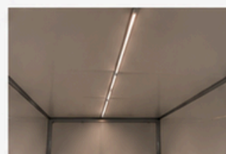
Éclairage LED intérieur
